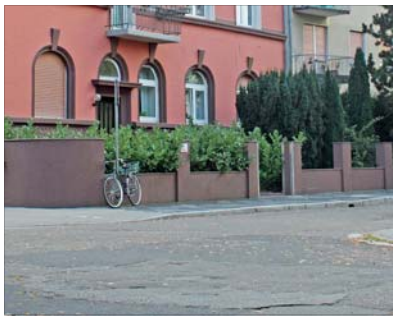
Marode Straßen gehören in Mannheim zum Stadtbild. Eine Verbesserung würde die Stadt Millionen kosten. Foto: Kranczoch
