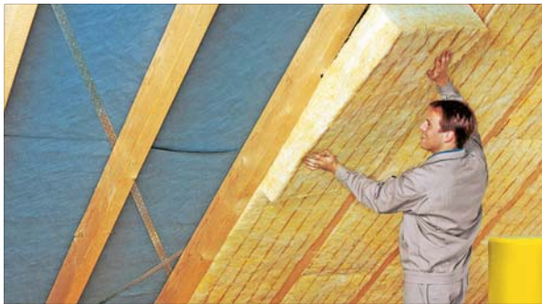
Mit einer effizienten Dämmung etwa aus Mineralwolle ist es meist möglich, eine kleiner dimensionierte Wärmepumpe einzubauen. Die Dämmung sorgt zudem für ganzjährig angenehme Raumtemperaturen und verbessert zugleich den Schall- und den Brandschutz. Foto: DJD/FMI/Getty Images/Steve Brookland
